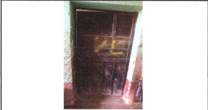
Foto 1: SE OBSERVA EL DETERIORO DE LA PUERTA DE LA DIRECCIÓN
