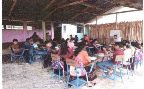
Foto 2: SE OBSERVA EL DETERIORO DEL TECHO Y LÁMINAS
