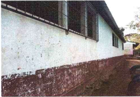
Foto 3: SE OBSERVA EL DETERIORO DE LA PINTURA EXTERIOR
