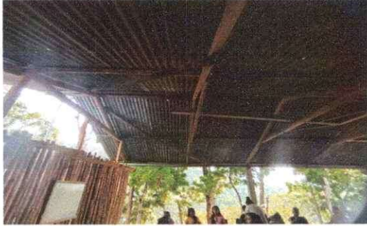
Foto 1: SE OBSERVA EL DETERIORO DE LÁMINAS
