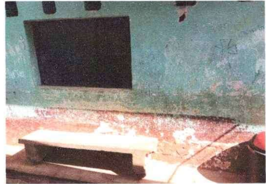
Foto 4: SE OBSERVA EL DETERIORO DE LA PINTURA EN PAREDES
