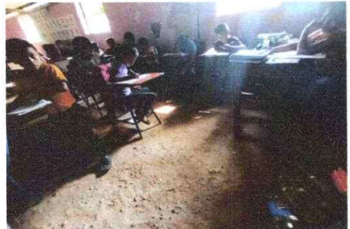
Foto 6: SE OBSERVA EL DETERIORO DEL PISO
