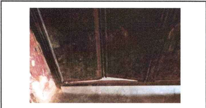
Foto 3: SE OBSERVA EL DETERIORO DE LA PUERTA DEL AULA
