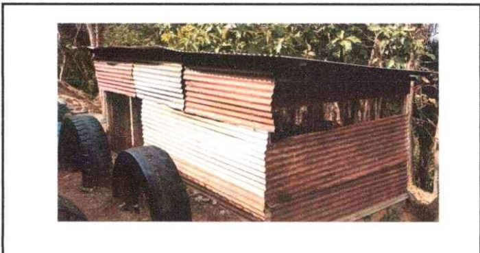
Foto 5: SE OBSERVA EL DETERIORO DE LAS LÁMINAS Y PAREDES DE LA COCINA
