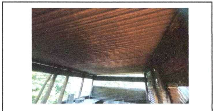
Foto 6: SE OBSERVA EL DETERIORO DE LAS LÁMINAS DE LA COCINA
